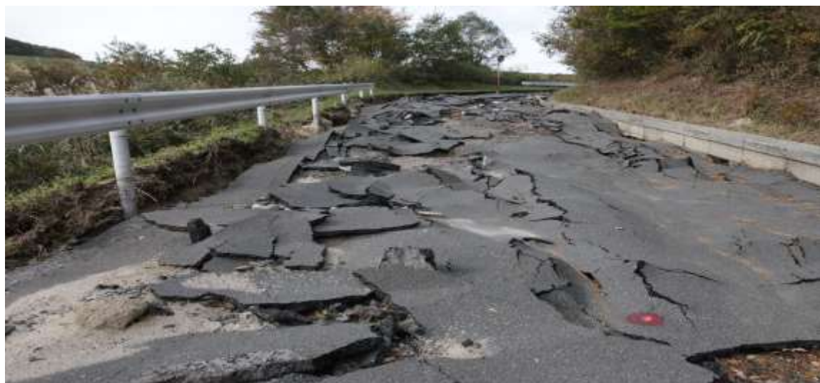
台風の影響でめくれあがってしまった道路。
